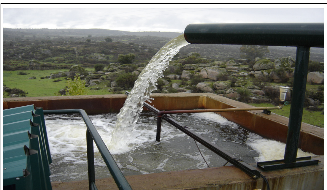
Figura 5: Estación Potabilizadora de la Mancomunidad de San Marcos
